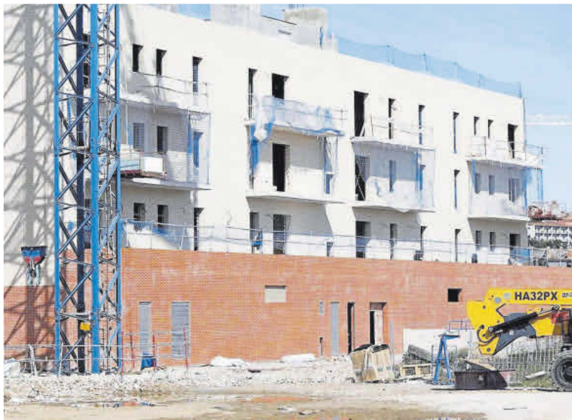
Habitatges en construcció al barri de Domeny de Girona a principis d'aquest any.
